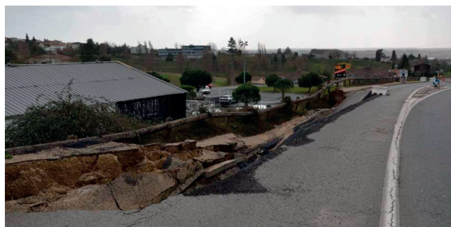
Effondrement de la RD 670 à La Réole suite aux intempéries, © Elise Artigue Cazcarra
