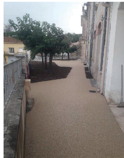
Désimperméabilisation de la cour d'école primaire de Bize Minervois, © Commune de Bize-Minervois
