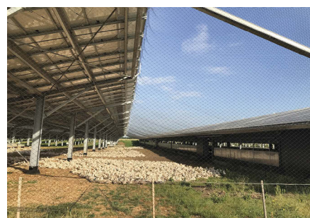
4 – Volière photovoltaïque de Rom (79) © Technique Solaire
