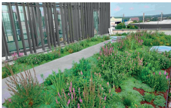
Toitures végétalisées, ne répondant pas aux objectifs de la renaturation - © Sol & co et Flore 54
