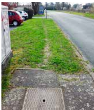
Des cheminements meubles, inconfortables.
