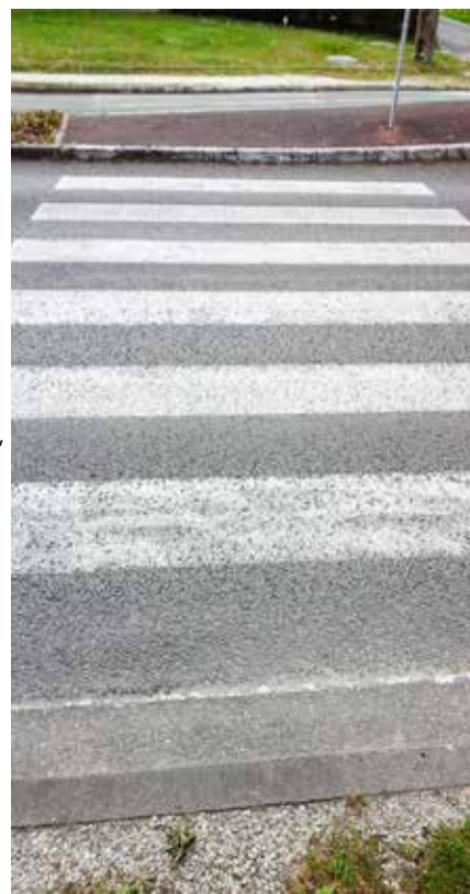
Une absence fréquente d'abaissé de trottoir.
