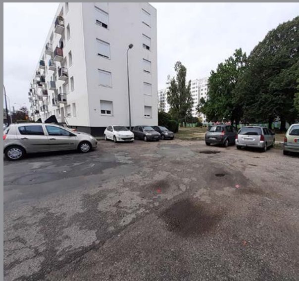
1 Enrobé sombre imperméable Pas de marquage des cheminements piétons
