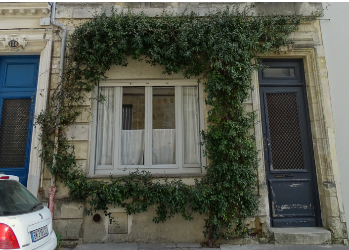
Absence de bordure permettant l'alimentation en eau des plantations
